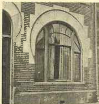
Afbeelding 6b Drielicht, waarvan de vensters op ongemotiveerde wijze door een boog zijn afgesneden en de roeden op een gezochte manier omgebogen. Lastige en ondeugdelijke konstruktie, vorm zonder verband met rest van raam of gevel
