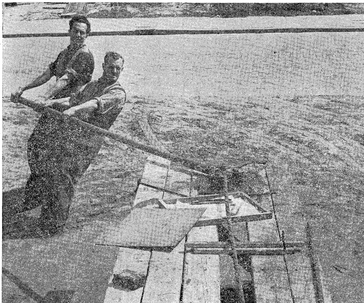
Het buigen van betonijzer in de vereiste vorm is een werkje waar heel wat spierkracht voor nodig is.
