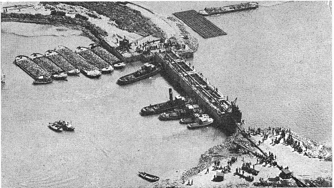
Weer werd een stroomgat op Schouwen en Duiveland gesloten. Hier werd aan 8 miljoen kubieke meter water, dat in een periode van 6 uur naar binnen en buiten stroomde, een halt toegeroepen. Door het dichtenvan Stevensluis werd de gehele NoorJkant van het rampgebied van het water afgesloten.
