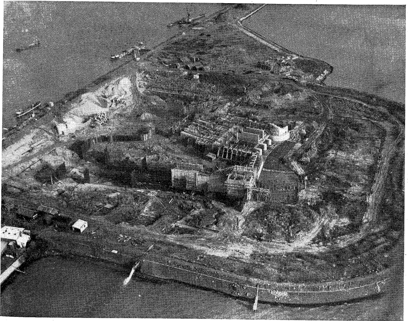
Het Gemaal „Wortman” in aanbouw. Wanneer de bedijking van Oostelijk Flevoland zal zijn voltooid, moet zo snel mogelijk met het afmalen van het water binnen de bedijking worden begonnen. Drie gemalen worden er op dit ogenblik gebouwd. De photo toont de bouw van het gemaal „Wortman” bij Lelystad. De pompen van dit gemaal zullen door dieselmotoren worden aangedreven. De capaciteit van de drie pompen zal 1500 m 3 water per minuut zijn 315 km 2 polder zal door dit gemaal droog worden gehouden.
