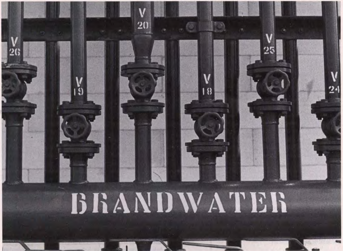
De blusinstallatie van een bedrijf voor verwerking van industrieel afval
